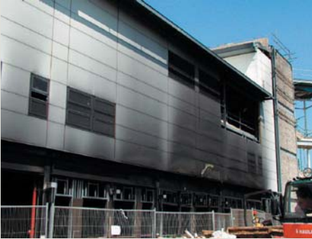
Zijkant van het gebouw (Foto 1) met het geëxposeerde geveldeel met rook en hitteschade vanaf de begane grond. Het is duidelijk dat het PIR kernmateriaal niet is ontbrand en geen rol heeft gespeeld bij de brand. De vlammen hebben bereikt tot aan de dakrand (een hoogte van circa 10 m). De stalen buitenhuid is vervormd en gedelamineerd van het kernmateriaal op plaatsen waar de buitenhuid in contact is geweest met de vlammen. Er is echter geen indicatie van brandvoortplanting door de sandwichpanelen.
