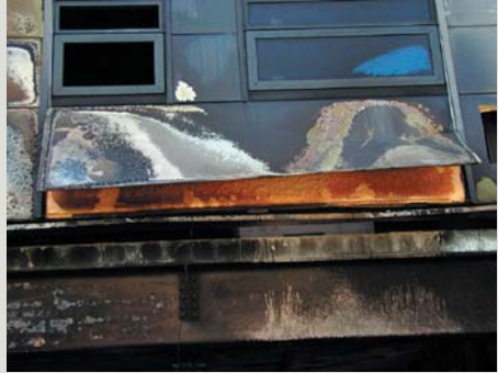
Een paneel met direct vlamcontact. De stalen buitenhuid is deels verwijderd om het PIR kernmateriaal te inspecteren. Het PIR kernmateriaal is bijna onaangetast en is slechts licht verkoold.
